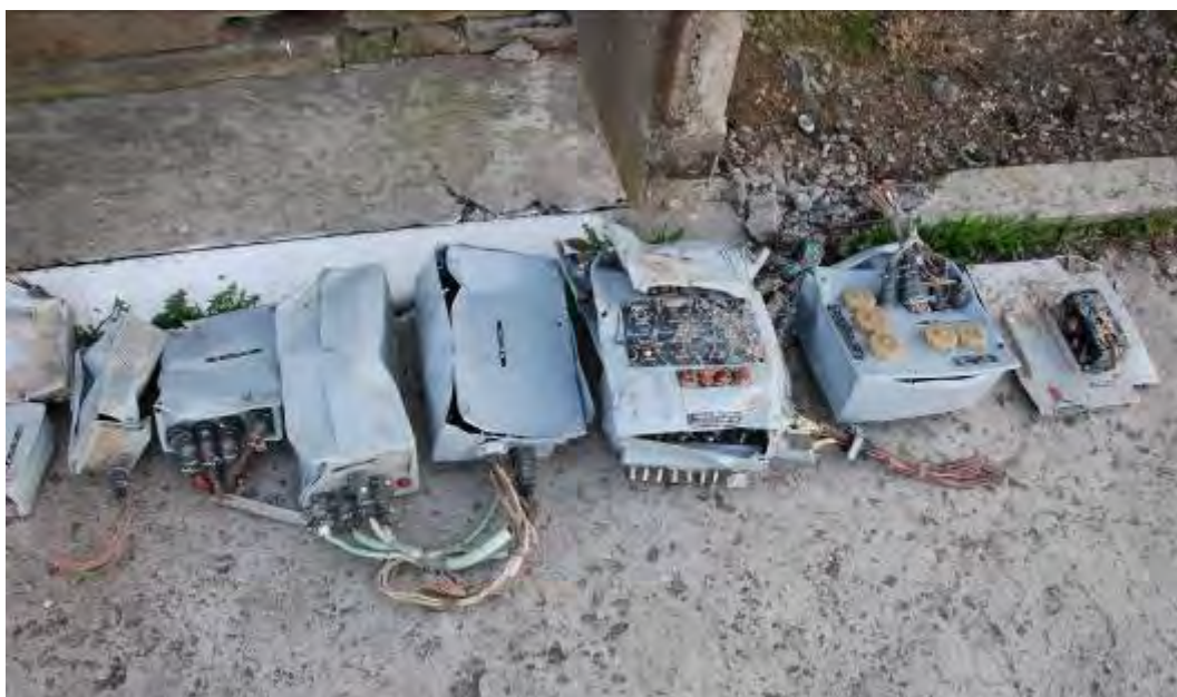
Rys. 30. Skrzynki sterowania instalacji elektrycznej
