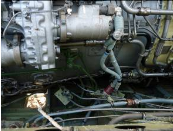
Zdj. 35. Widok agregatów silnikowych oraz elementów sterowania silnikiem
