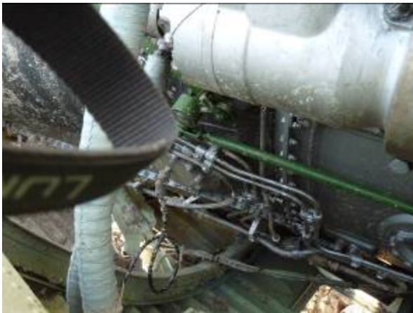
Zdj. 37. Widok elementów sterowania silnikiem
