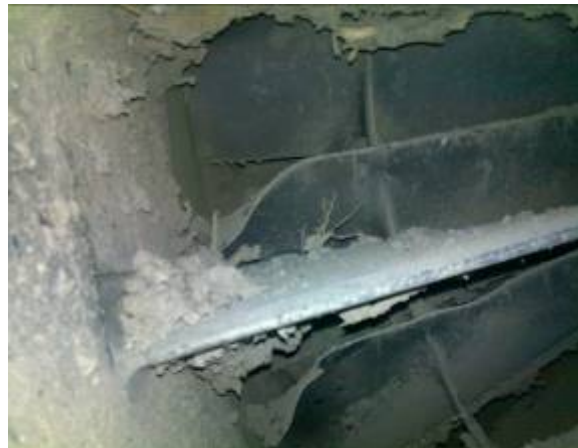
Zdj. 8. Widok uszkodzeń na krawędziach natarcia łopatek I st. SNC
