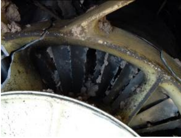
Zdj. 7. Korpus rozdzielczy - widok łopatek SWC
