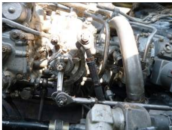
Zdj. 33. Widok agregatów silnikowych oraz elementów sterowania silnikiem – noniusz na pompie NR-30KU-4
