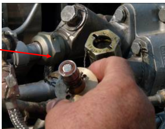
Zdj. 18. Korek magnetyczny zabudowany na pompie odsysającej MNO-30K
