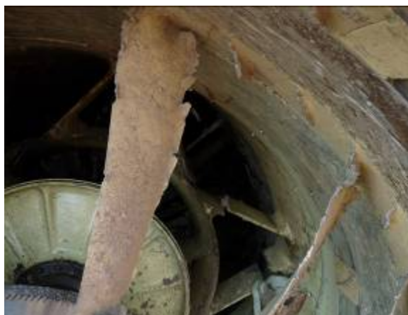
Zdj. 6. Widok stanu sprężarki niskiego ciśnienia
